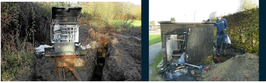
Şekil 2.3 Trafo Patlamasından Sonra, Herhangi Bir Olası Toprak Kirliliği İçin Toprak Kontrol Edilmelidir
