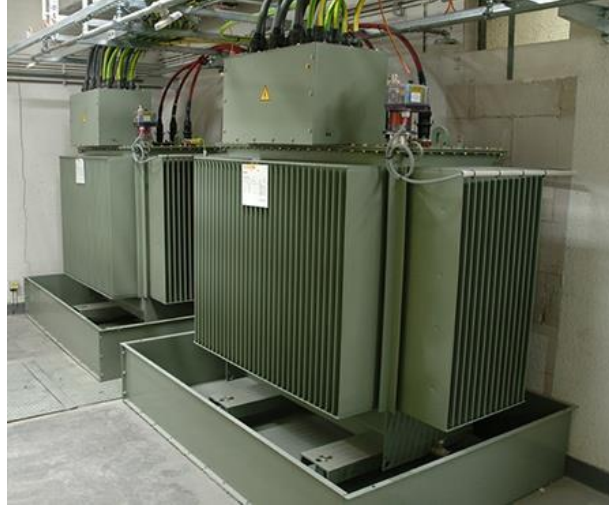
Şekil 3.12 PCB İçeren Trafonun Tava İçinde Depolanması
