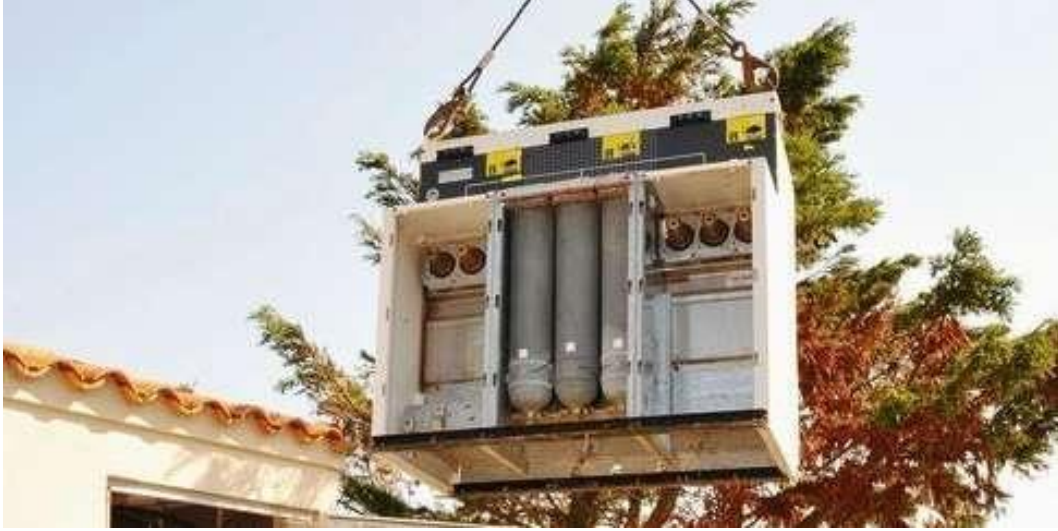
Şekil 3.8 Tuz ile Korozyona Uğramış Trafo (Fransa Batı Sahili)
