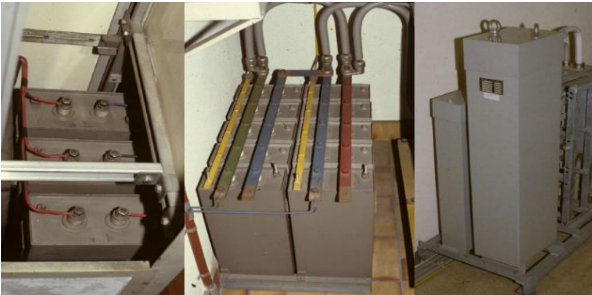
Şekil 3.9 Sökülmeden Önce PCB İçeren Kapasitörlerin ve Kondansatörlerin Tanımlanması
