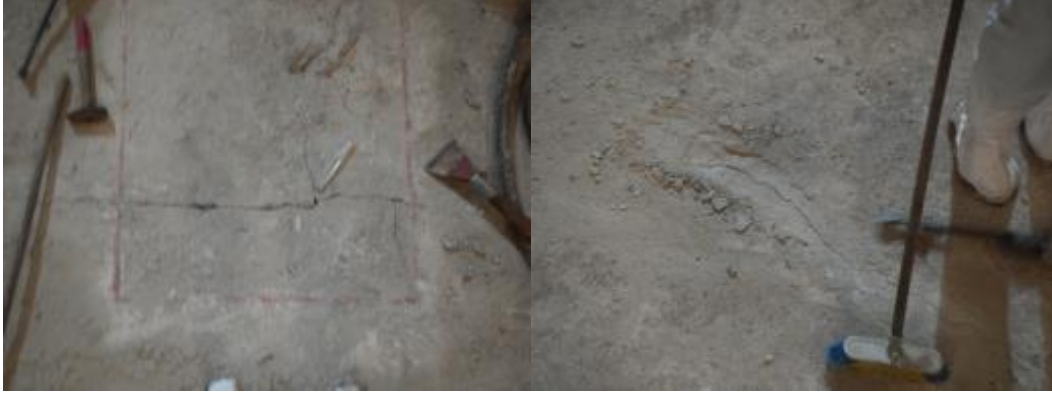
Şekil 8.1 Sahada zeminlerde gözlenen büyük çatlaklar (4 nolu depo)
