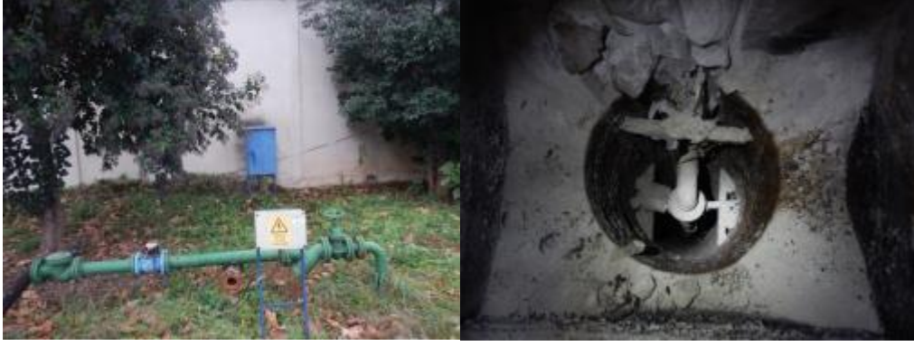
Şekil 2.1 Su çıkartma kuyusu (solda) ve 2 nolu depoda bulunan kapalı alan kuyusu (sağda).
